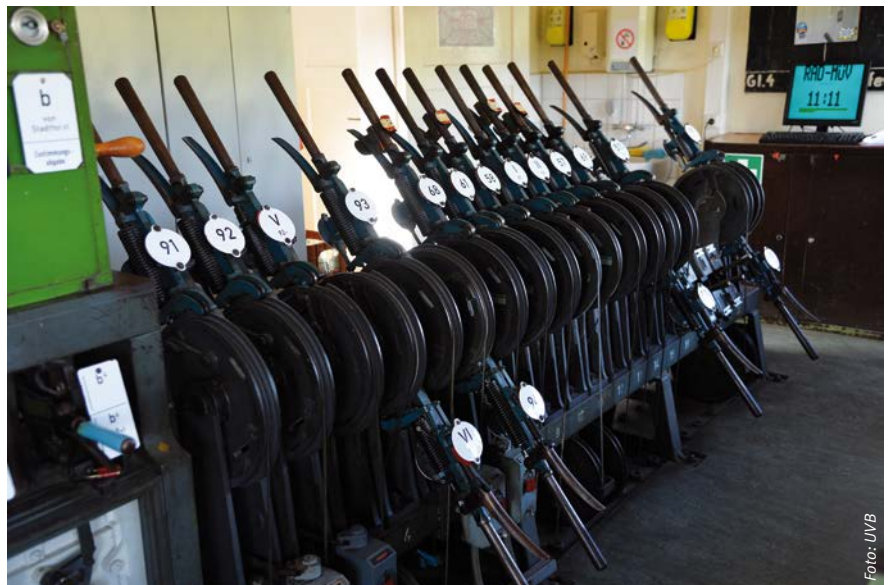
Abbildung 3: Hebelwerk im mechanischen Stellwerk
